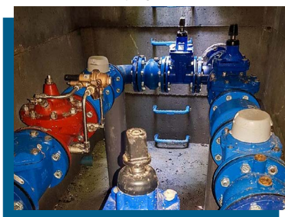
La chambre de comptage de l'interconnexion
